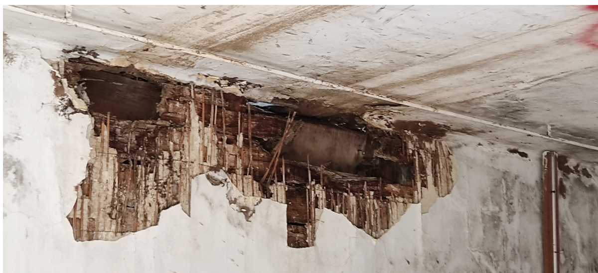
4. Az emelet feletti födém beázva
