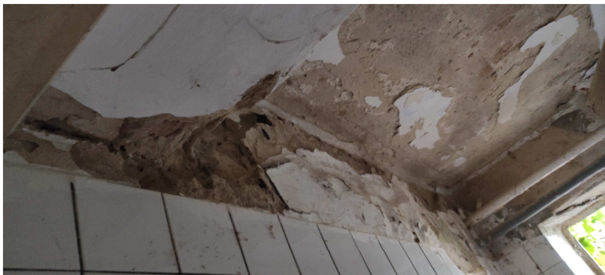
2. A pince feletti födém beázva
