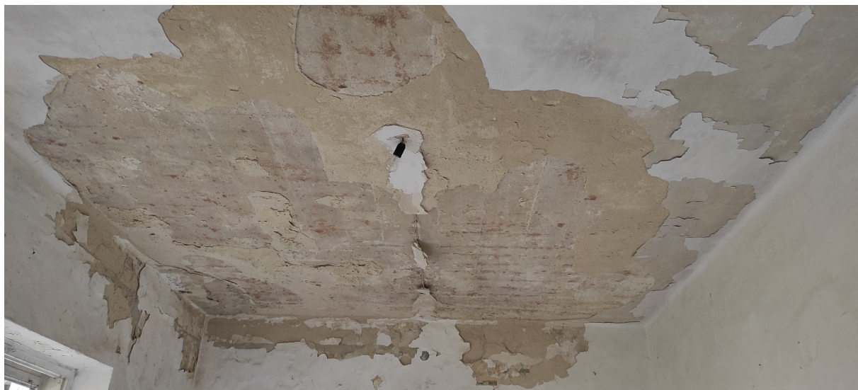
3. A földszint feletti födém beázva
